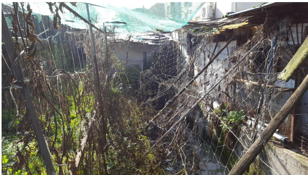
Figura 5.36 – Edificio abusivo in alveo
