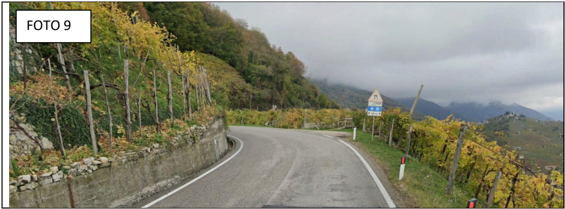
Figura 5.44 – Foto 8-9: Lungo la SP 36, si osservano ruscellamenti intensi che erodono le scarpate e invadono i vigneti a Est, con solchi visibili e perdita di terreno coltivabile.
