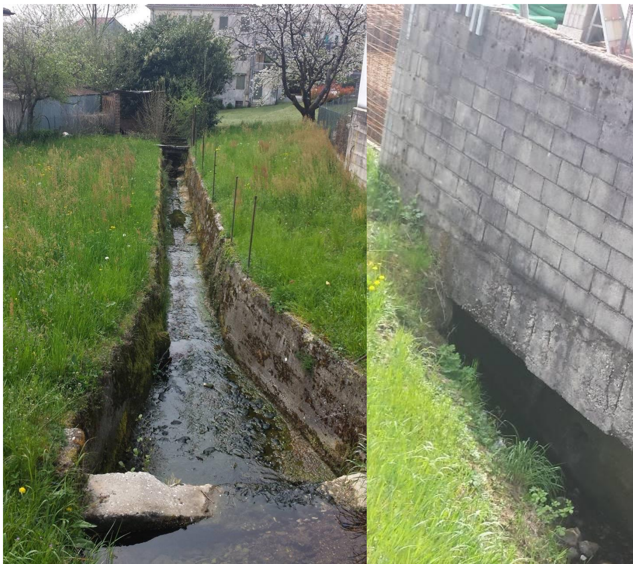
Figura 5.27 – Torrente La Roggia a monte e a valle del restringimento che caratterizza la criticità 12
