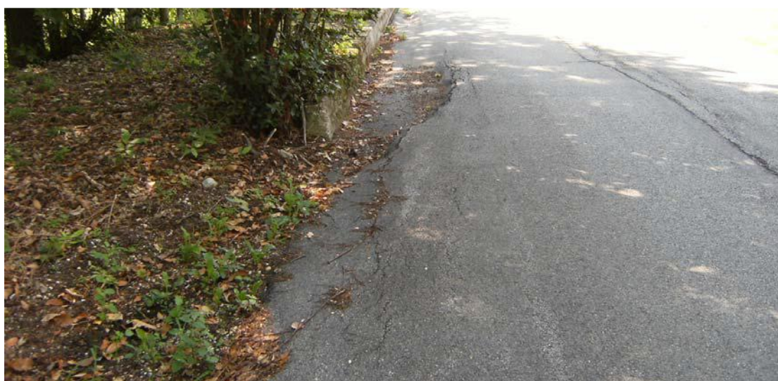
Figura 5.41 – Cedimento della sede stradale a monte del tornante sulla strada del Madean (SP36)
