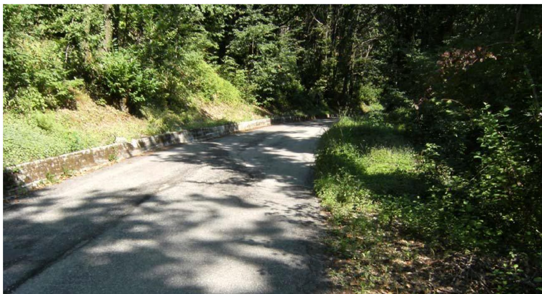
Figura 5.40 – Cedimento della sede stradale a valle del tornante sulla strada del Madean (SP36)
