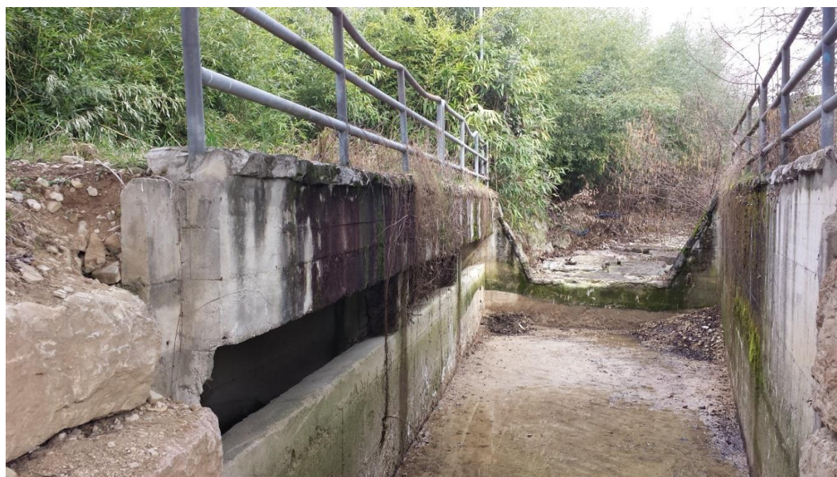
Figura 5.19 – Manufatto di sfioro
