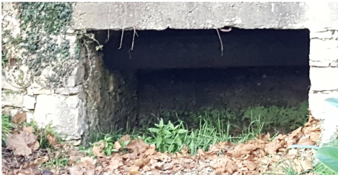
Figura 3.2 – Sezione di sbocco parzialmente ostruita
